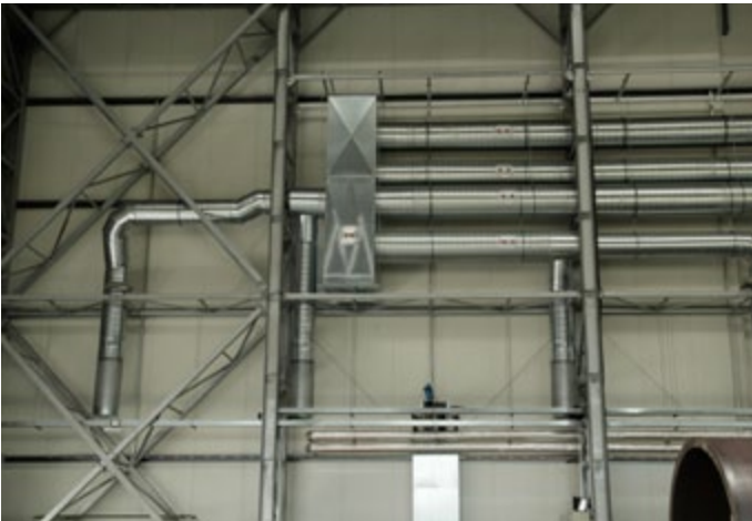
Energomontaż, instalacja wentylacyjna
